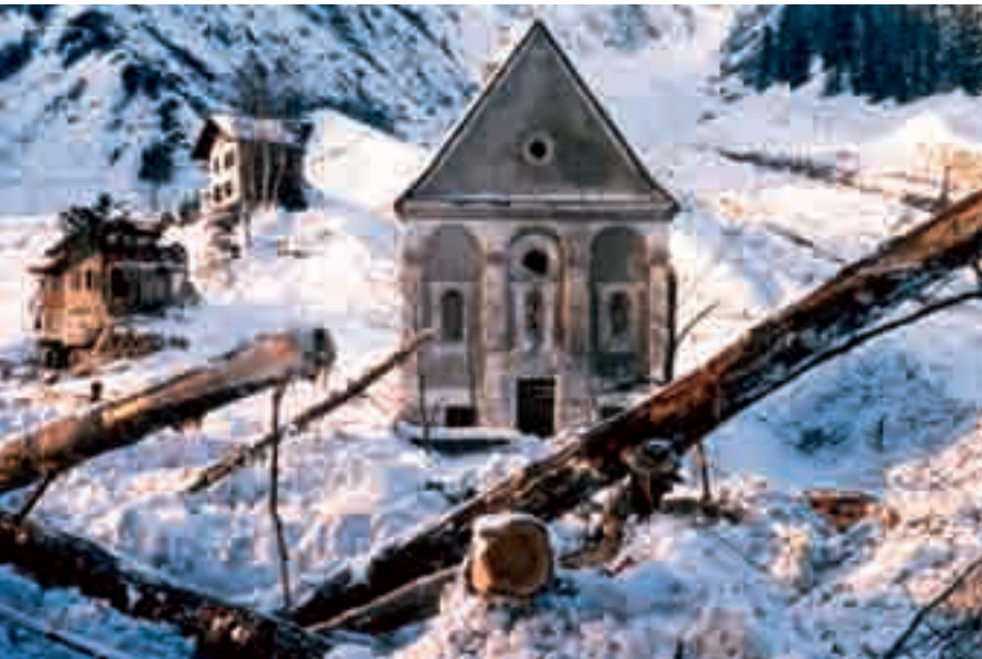
Von einer Katastrophenlawine beschädigte Gebäude. Der Lawinenablenkdamm (in der Bildmitte) konnte die Schäden zwar verringern, nicht aber verhindern.
